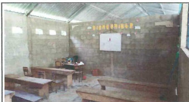
Foto 3: El aula de párvulos no está repellada, necesita repello.
